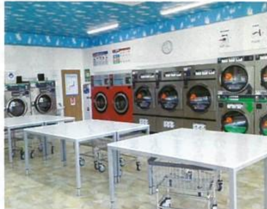
スーパーやコンビニに併設するかたちで出店すれば、駐車場も共用となり集客しやすい。洗濯機や乾燥機などの設備費が高額だが、修理費を考えると最初から新品を買ったほうがコスパは高い
